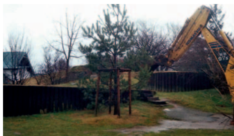
Odpaliště č. 4 krátce před rekonstrukcí...
